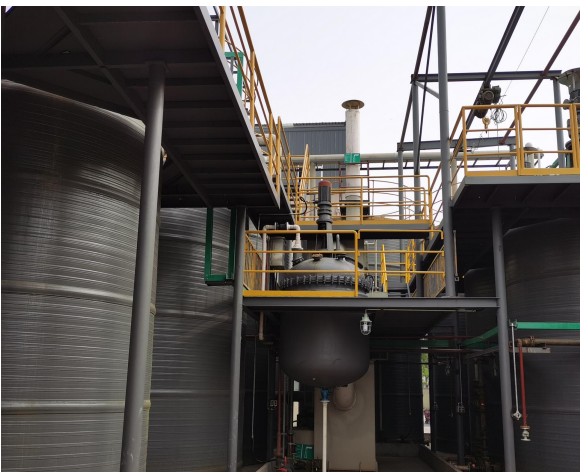
水处理站废气排气筒和标识
