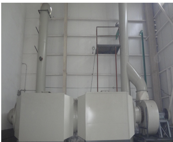
危废仓库废气处理设施
