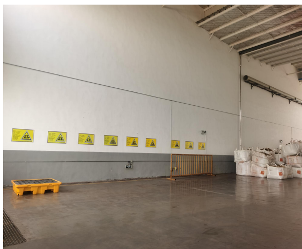
防渗防腐地面、托盘、收集导流沟
