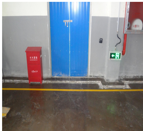
危废仓库1区截留措施
