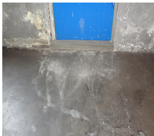
固废仓库2区截留措施
